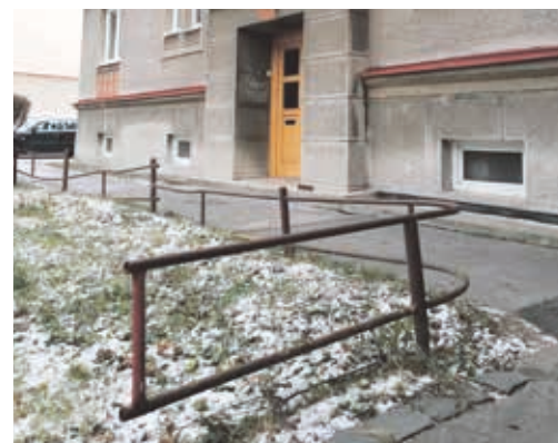
Poškodené zábradlie treba zrekonštruovať
