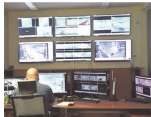
Kamerový monitorovací systém
