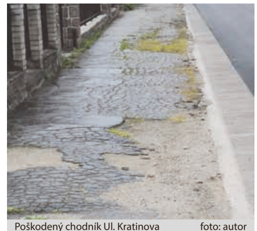
Poškodený chodník Ul. Kratinova
