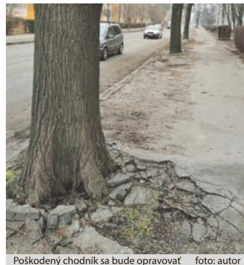
Poškodený chodník sa bude opravovať foto: autor
