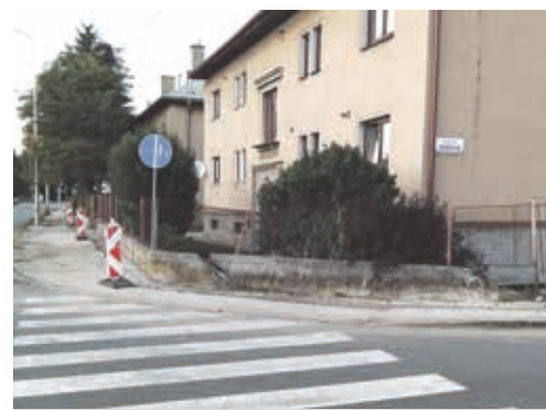
Poškodený plot foto: autor
