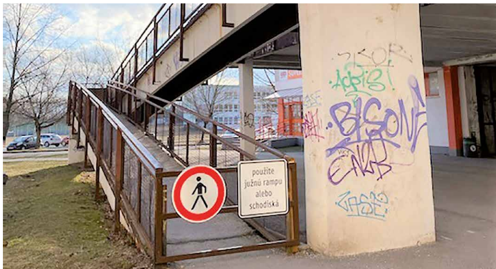
Pešie plató už dlhší čas čaká na rekonštrukciu. Komplikujú ju aj stále sa meniace ceny stavebných materiálov. Foto: Jana Cikhartová
