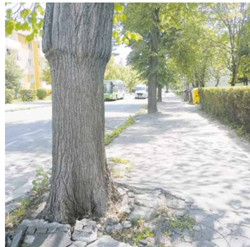
Poškodený chodník na Ulici P. O. Hviezdoslava bude obnovený aj s náhradnou alejovou výsadbou stromov. Foto: Bruno Horecký
