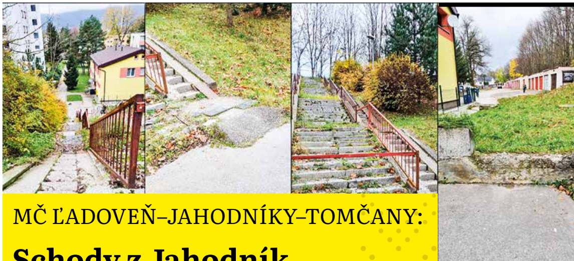
Stav schodiska dnes. Rekonštrukcia je nevyhnutná. Foto: ÚHA
