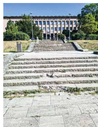
Schody pod múzeom, oprava je nutná. Foto: Roman Kopka
