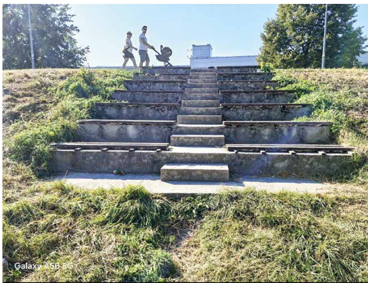
Poškodené sedenie pri rieke Turiec v zadnej časti OC Tulip čaká oprava. Na potrebný materiál prispeli tri mestské časti. Foto: Roman Kopka
